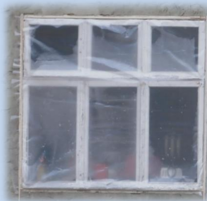
Okno zateplené fóliou
